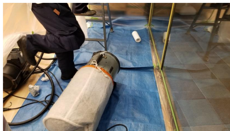
ダクトにて排気
