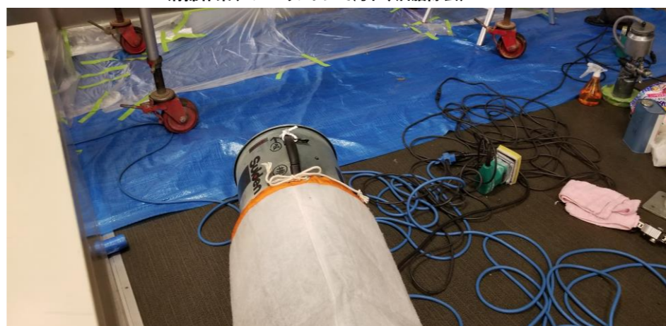
ダクトにて排気
