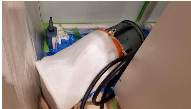
ダクトにて排気
