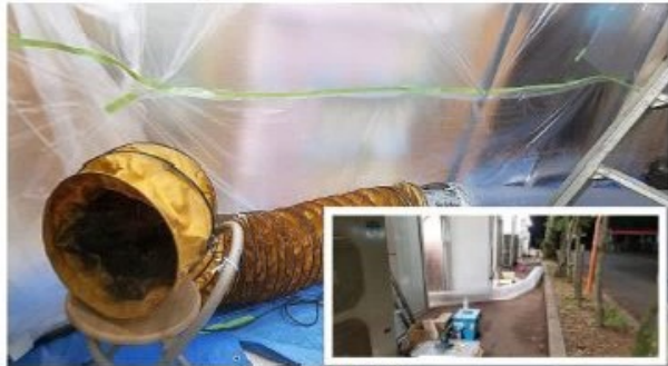
ダクトにて排気
