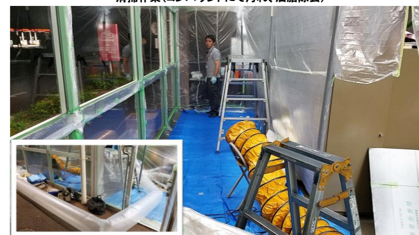
ダクトにて排気
