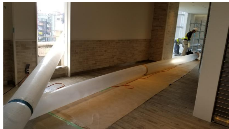
ダクトにて排気
